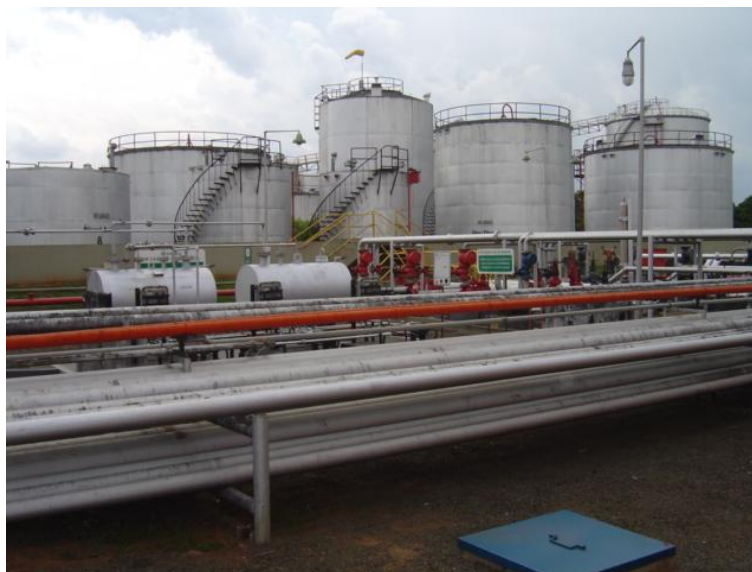
Figura 1: Vista da área de tancagem e linhas de distribuição de produtos.
